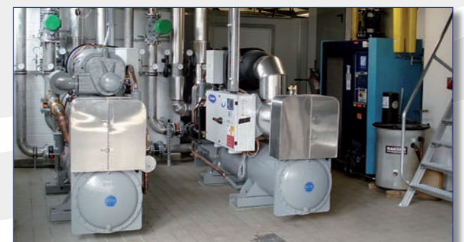
Eine der Kältezentralen
